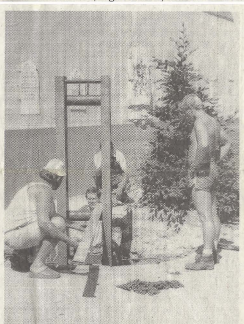
Neben der Kirche wird der Jubiläumsbaum aufgestellt. Kolpingsöhne haben bereits die Halterung einbetoniert. Bild: uto
